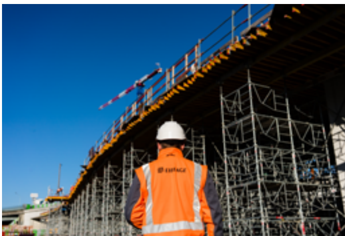
Paris — Eiffage Génie Civil réalise les travaux de restructuration de l'échangeur quai d'Ivry du boulevard périphérique, sur la ZAC Paris Rive Gauche.
