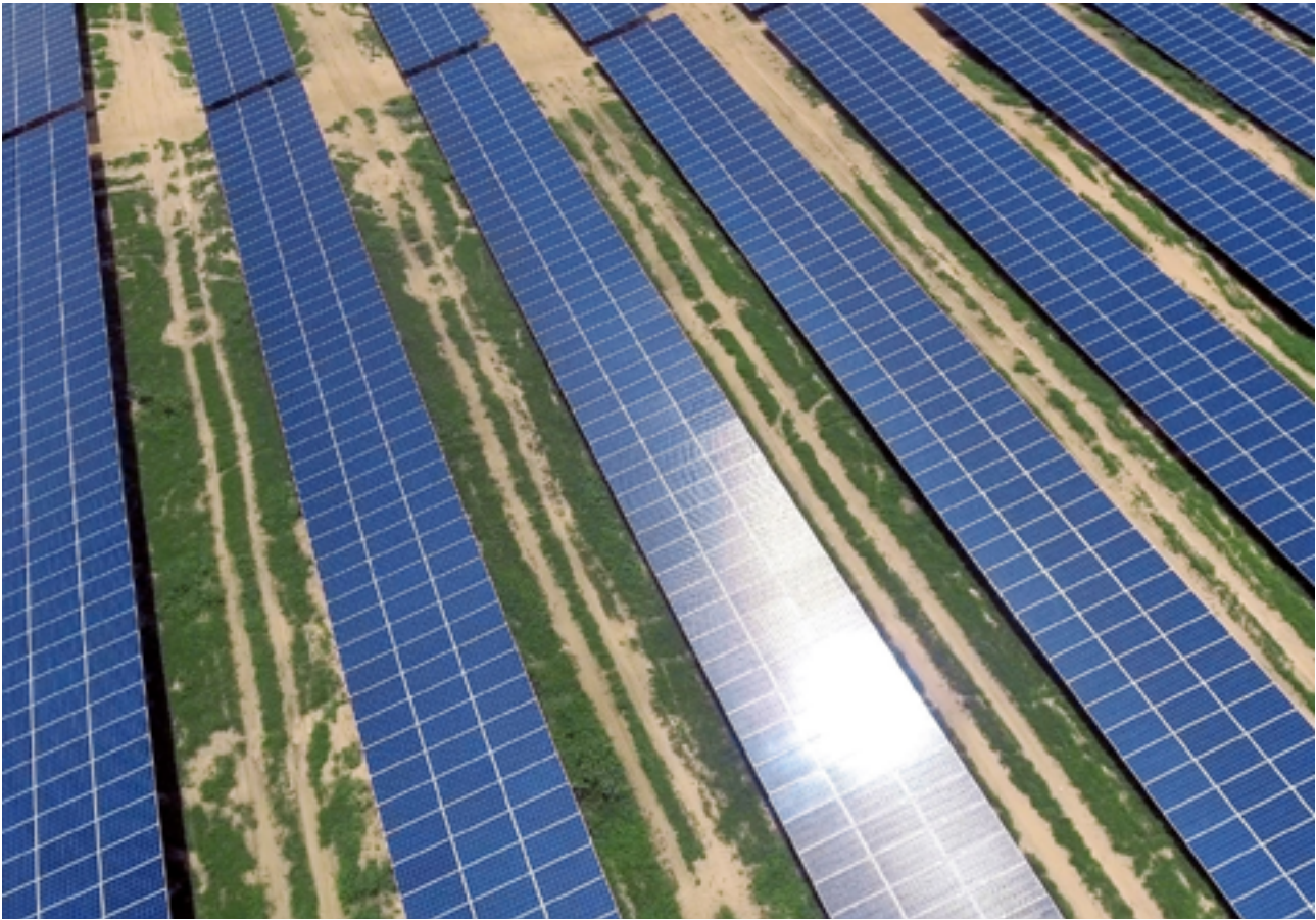
Ten Merina (Sénégal) — Centrale photovoltaïque.
